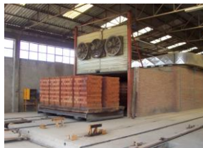
ΤΕΧΝΟΚΕΡΑΜΙΚΗ Α.Β.Ε.Ε. 93m Φούρνος τούνελ
